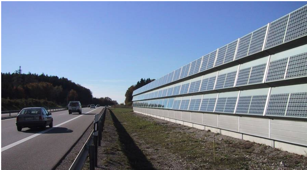
Abb. 3.6: Photovoltaikanlage an einer LSW an der A96 am Ammersee in Deutschland realisiert mit dem Anlagentyp Schindeln
