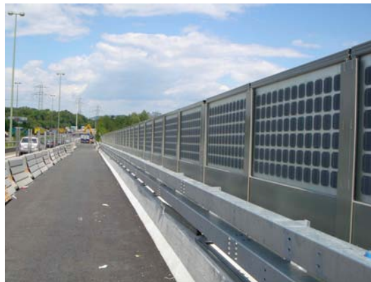
Abb. 1.12: Typ Bifacial entlang der Autobahnüberführung in Zürich
