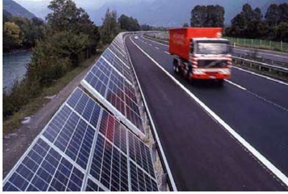
Abb. 7.2: Domat/EMS, PV-Anlage auf bestehende Lärmschutzanlage aufgesetzt
