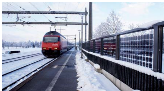
Abb. 7.3: Integrierte bifaciale Photovoltaik-Schallschutzanlage in Münsingen
