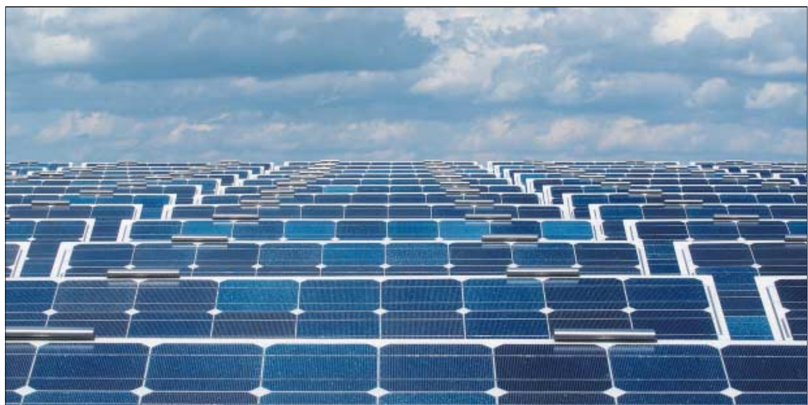
Bessere politische als klimatische Voraussetzungen: Solarkraftwerk auf dem Dach des Messegeländes in Freiburg.
